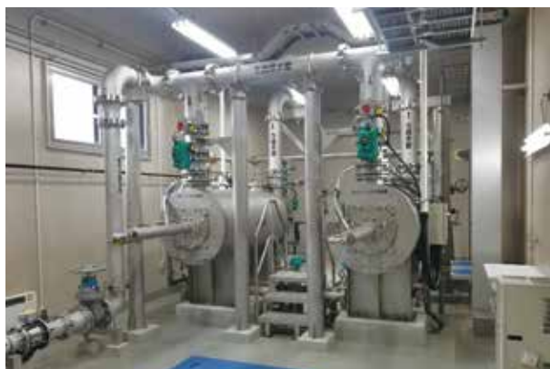
置戸浄水場内部
