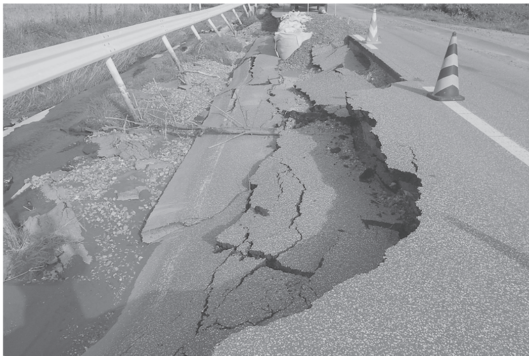
▼大雨により陥没した秋田中里線道路
