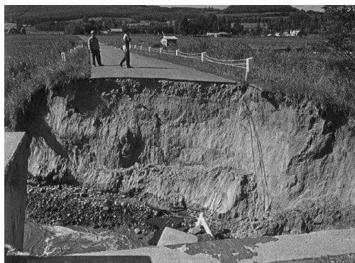
集中豪雨の影響で決壊した道路
